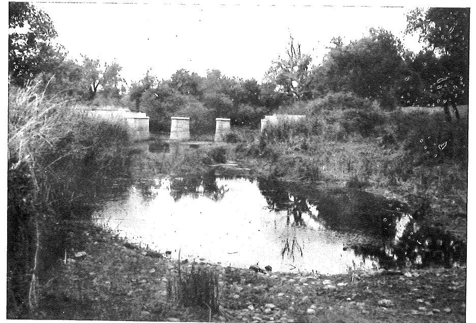
Fig. 2.—Aspecto del cauce de la rivera del Lácara, en el paraje del Prado del Lácara. El tablero del puente de la carretera fué arrastrado por las aguas en la avenida invernal de 1945.
